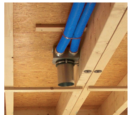
Venttiiliyhde asennettuna kattoon.
