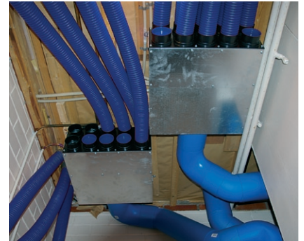
Ääniä vaimentavat poisto- ja tuloilman jakolaatikat.
